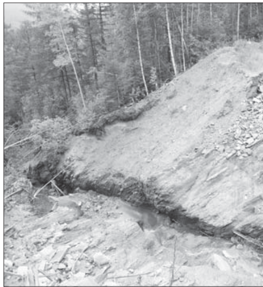
Разрыв дороги Мама – Горная Чуя 112-й км
